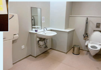
多目的トイレ
